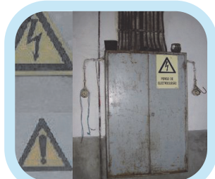
Figura 52 și 53 – Instalațiile electrice
