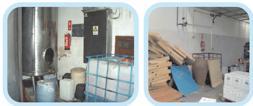
Figura 54 și 55 – Prevederea unor stingătoare de incendiu în vinărie
